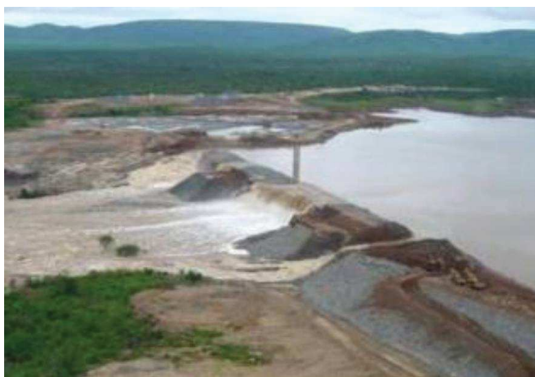
Figura 22: Exemplo de situação de emergência em barragem no Ceará.
