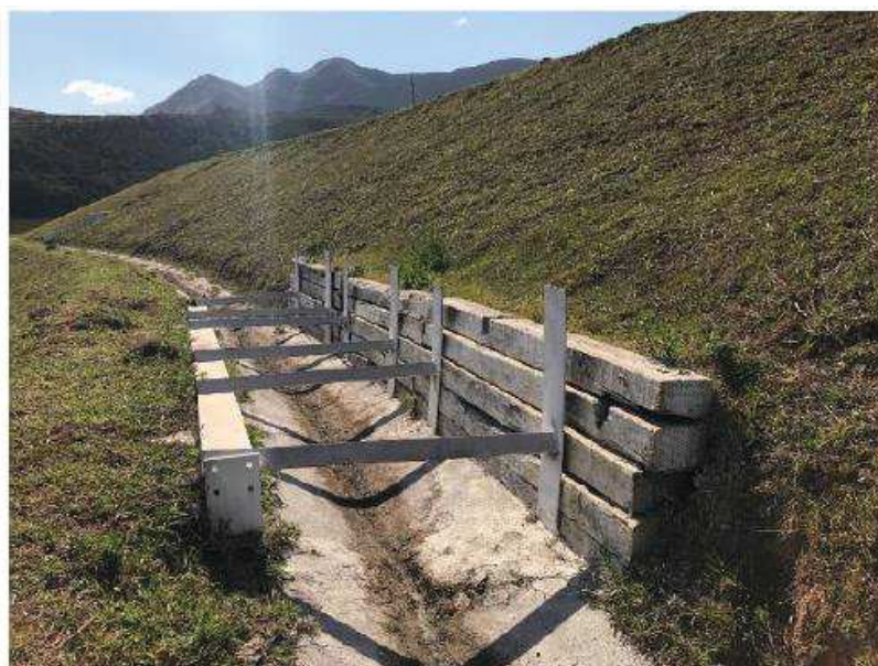
Foto 19 – Escoramento realizado em um talude da barragem que apresentou ruptura local EL. 895m.
