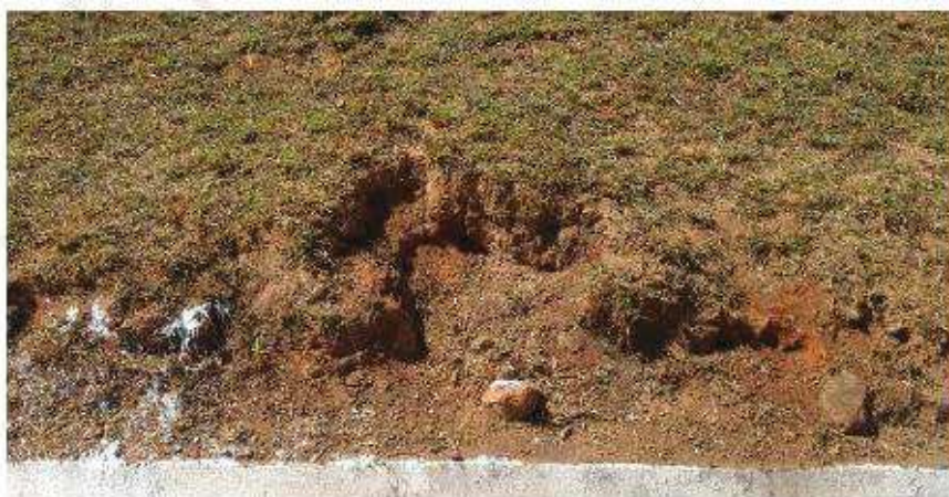
Foto 8 - Pequeno foco erosivo na El. 922,5 m.
