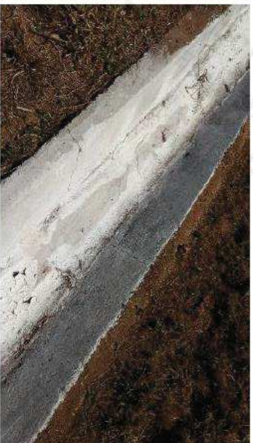
Foto 6 – Canaletas trincadas na região do maciço na ombreira esquerda – EL. 929,5 m.
