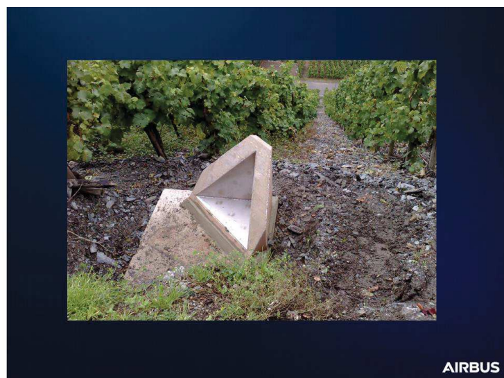
Figura 42: Marco utilizado para monitoramento de deslizamentos de encostas.
