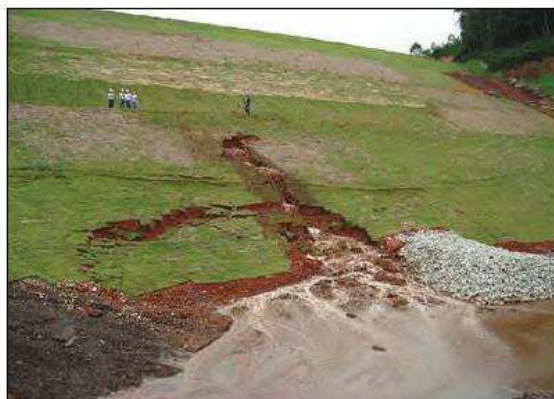
Figura 2-6 Efeitos da erosão interna no talude de jusante do Dique 1
