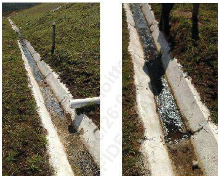
Foto 12 – Surgência de água na canaleta próxima a segunda trincheira (da ombreira direita para esquerda) na berma na EL. 899 m.
