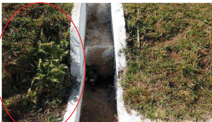
Foto 11 – Inclinação da parede da descida d'água na terceira trincheira (da ombreira direita para esquerda) na bermã na EL. 899 m.
