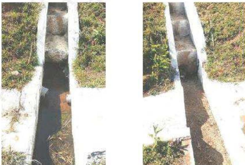
Foto 10 – Solapamento da base (contato entre a descida e o canal) nas trincheiras indicadas existentes na bermã na EL. 899 m).
