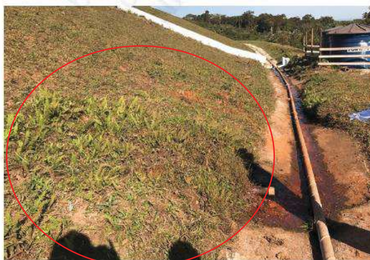
Foto 16 - Presença de colóide na saída do dreno interno que deságua no contato do maciço com a ombreira direita. Observar área de saturação de face.
