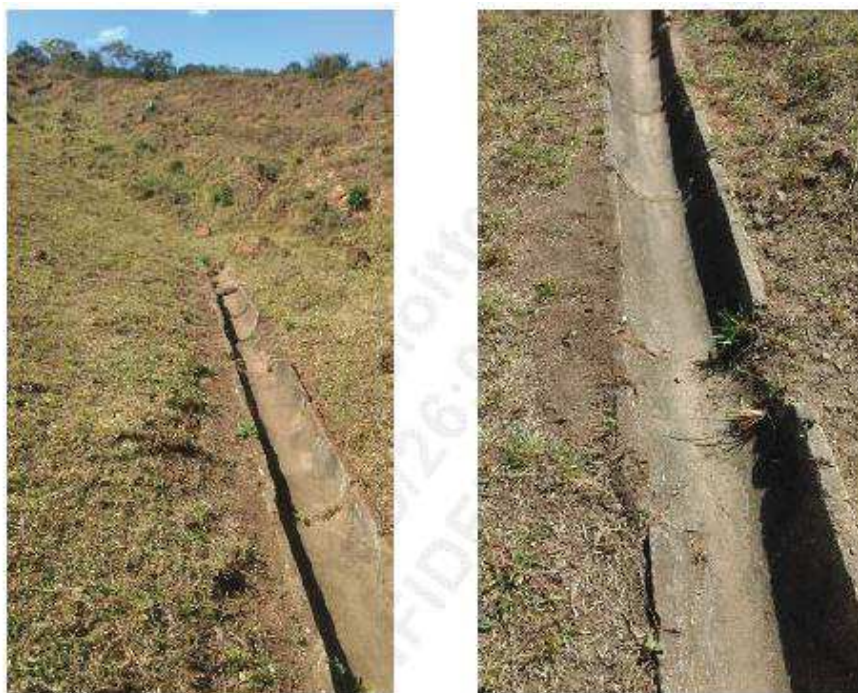
Foto 7 – Canaletas trincadas na região do maciço, ombreira esquerda (ELs.916,5 e 910 m).
