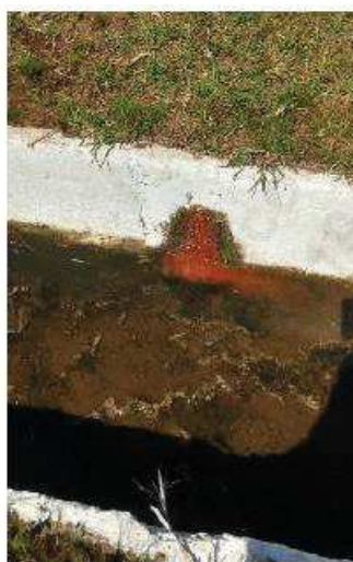
Foto 13 – Presença de colóide na saída do dreno interno que desagua no canal da segunda trincheira (da ombreira direita para esquerda) na berma na EL. 899 m.
