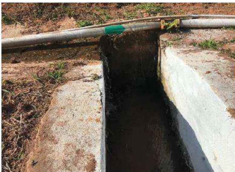
Foto 17 – Solapamento no início da descida d'água em escada, na berma da EL. 872 m.
