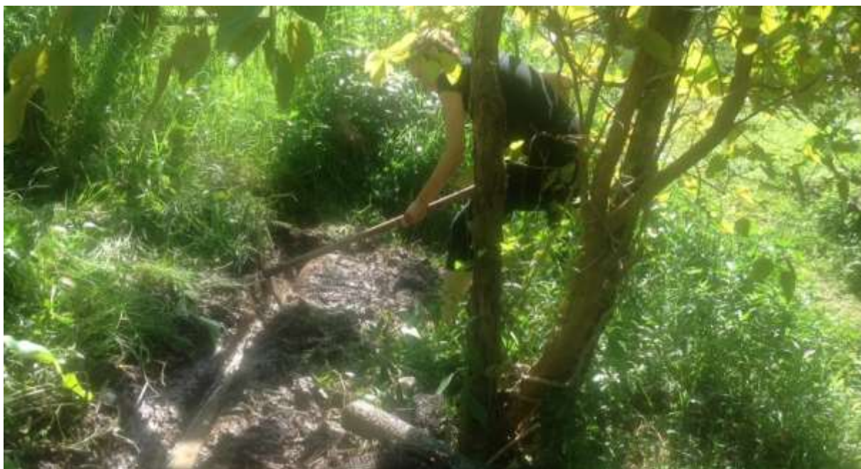
Figura 83 – A voluntária Andrea Pesek, que possui maior expertise no trato com as águas, abre caminho na área da nascente para que a água corra com maior velocidade até a cacimba. Uma das tentativas pretéritas havia sido por meio da instalação de um cano condutor, que acabou sendo removido, dando preferência ao escoamento superficial. São Paulo/SP, Brasil. Foto de junho de 2015. Crédito: Gustavo Nagib.
