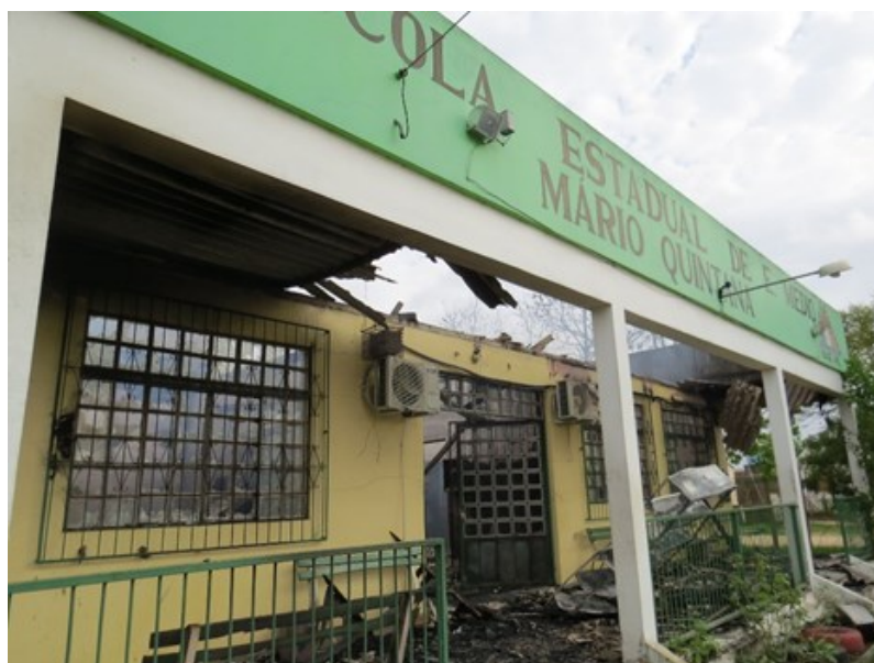
Escola Mário Quintana (Bagé) destruída por um incêndio.
