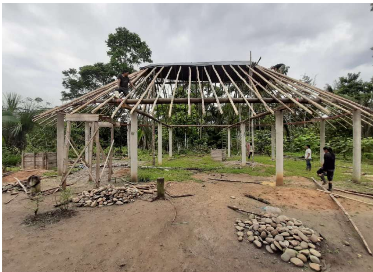
Imagem 44: casa de festa de Mirian e Marlon em processo de construção (Sarayaku, agosto 2019).
