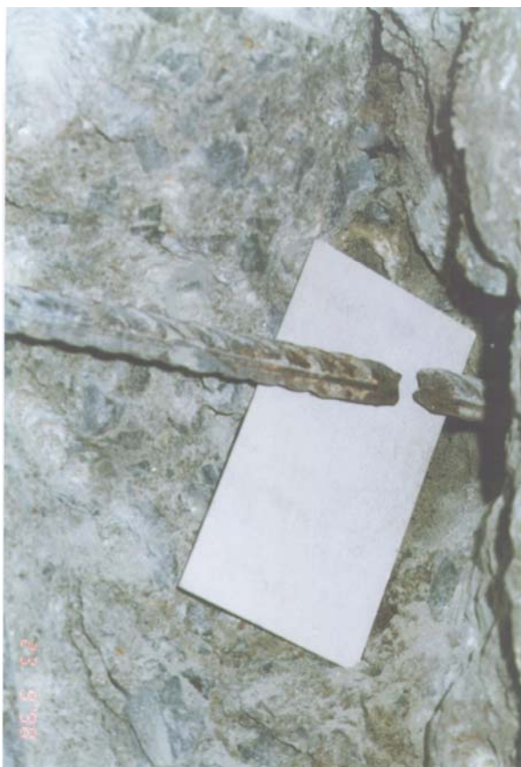
FOTO 2 – Ruptura com Espaçamento de 5 mm na Barra Horizontal do P25.
