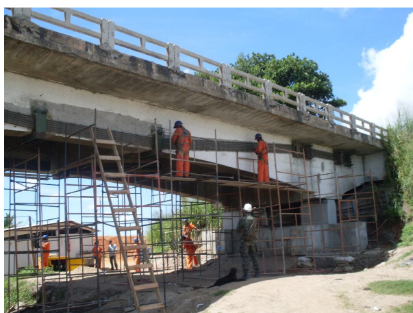
Foto 6 – Configuração do traçado da protensão externa ao longo das faces laterais das vigas principais.
