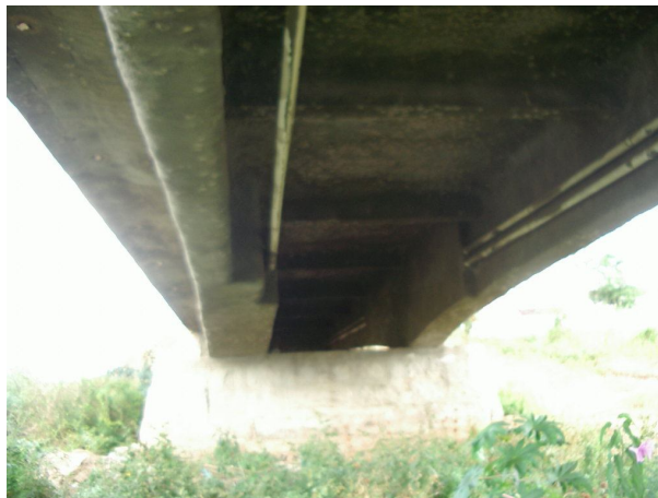
Foto 1 – Reforço das vigas principais de uma ponte por meio de protensão externa com cabos embutidos em bainhas flexíveis. Observar os grandes blocos de concreto nas regiões dos apoios para garantir a passagem dos desviadores e resistir à grande concentração de tensões.
