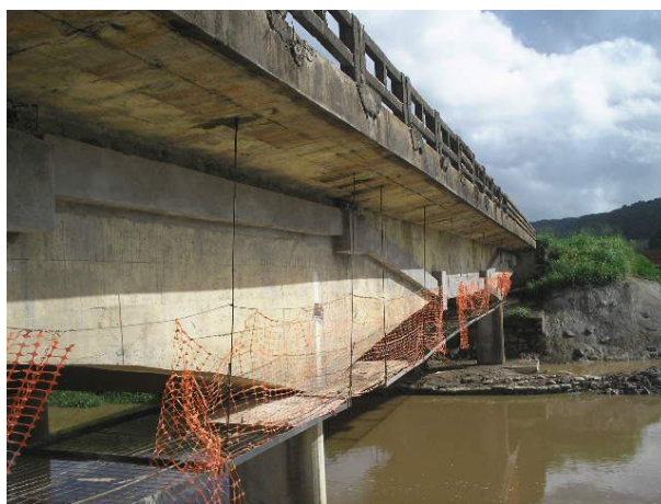
Foto 7 – Reforço e envolvimento das cordoalhas e desviadores metálicos com concreto após a conclusão da protensão.
