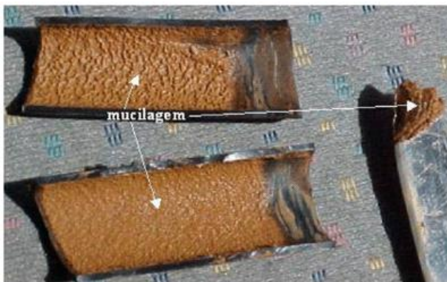
Figura 2. Mucilagem formada nas paredes internas dos tubos de polietileno de baixa densidade com detalhe de uma raspagem feita com canivete em um segmento do tubo
