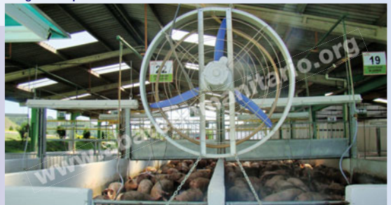
Perda de calor por convecção – ventilação forçada na área de descanso
