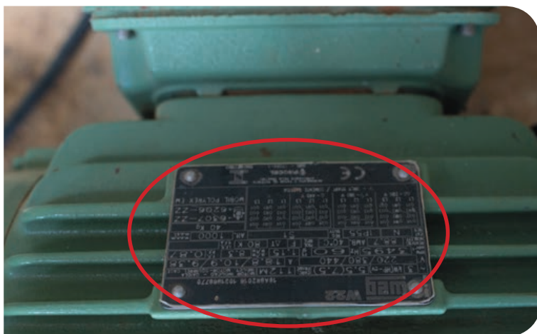
Motor elétrico com detalhe da plaqueta
