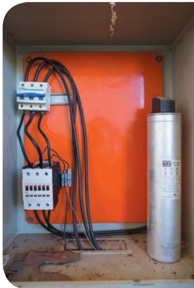
Capacitor do transformador
