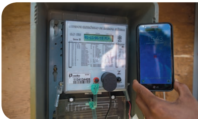
Aferição de data e hora do medidor de energia
