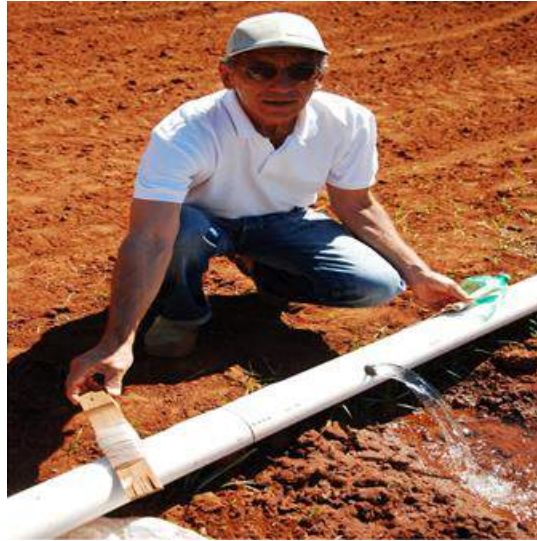
Figura 4. Parte superior da garrafa PET de 2 L e linha de nylon para bloquear o escoamento na tubulação e forçar a saída de água nos orifícios.
