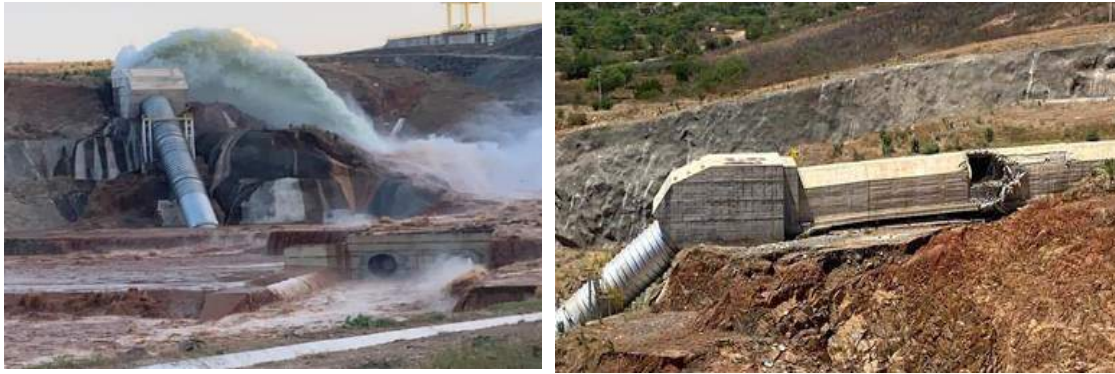
Figura 3. Detalhes do rompimento da adutora da hidroelétrica da Barragem do Jati, Ceará, Projeto de Integração do Rio São Francisco
