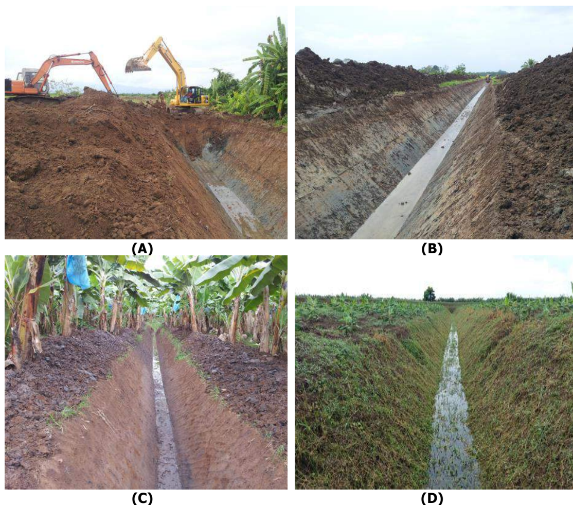
Figura 7. Abertura de valetas na Costa Rica (A) e (B) com posterior plantio de bananeiras (C) e a necessidade de serviços de manutenção (D) (Gentileza do Prof. Adrián Enrique Chavarría Vidal, Professor do Instituto Tecnológico de Costa Rica, Escuela de Ingeniería Agrícola).
