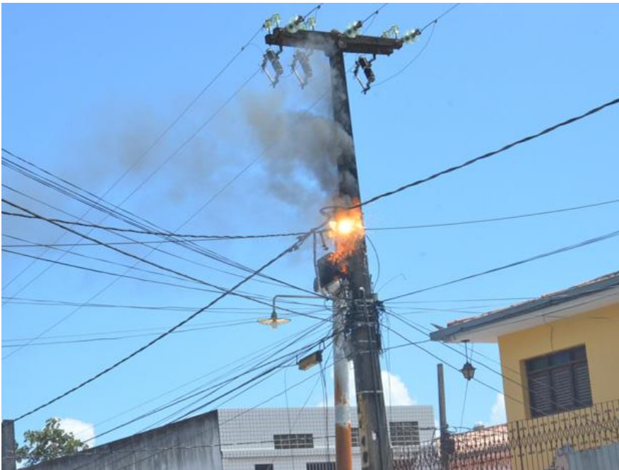
Faltas em Trafos
