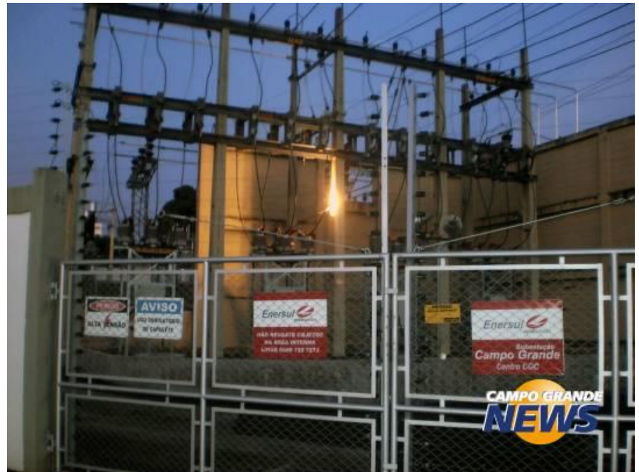
CC em Transformador de Subestação
