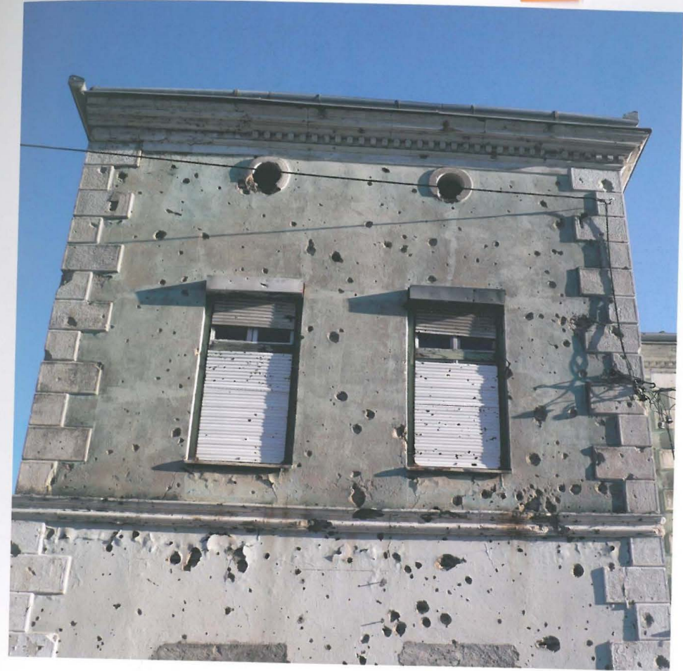
Pontos destrutivos Nunca subestime a força de um ponto. Esta fachada danificada foi fotografada numa cidade assolada pela guerra, Mostar, na Bósnia-Herzegovina, Península Balcânica. Nancy Froehlich.
