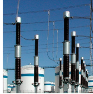
(b) Transformador de potencial
