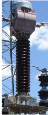
(a) Transformador de corrente
