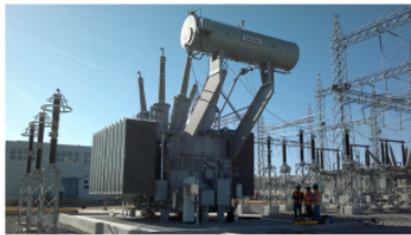
(a) Transformador de potência
