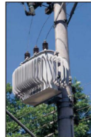
(b) Transformador de distribuição
