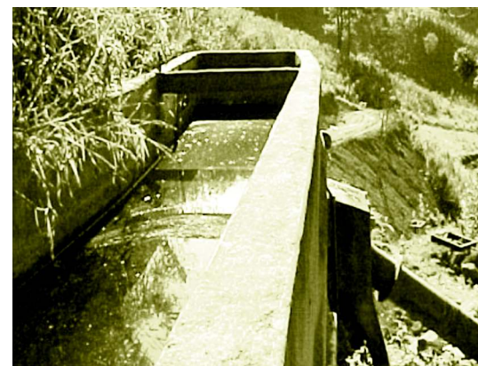
Figura 4.6 – Aspecto de uma câmara de carga e bloco de ancoragem de saída
