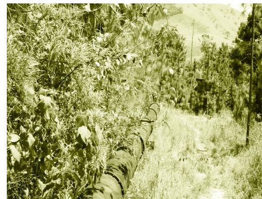
Figura 4.5 – Parte de um conduto metálico de baixa pressão
