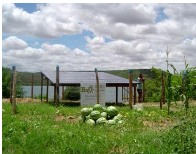
Figura A3.3 – Gerador fotovoltaico de Traíras. Fonte: (MORALES, 2011).
