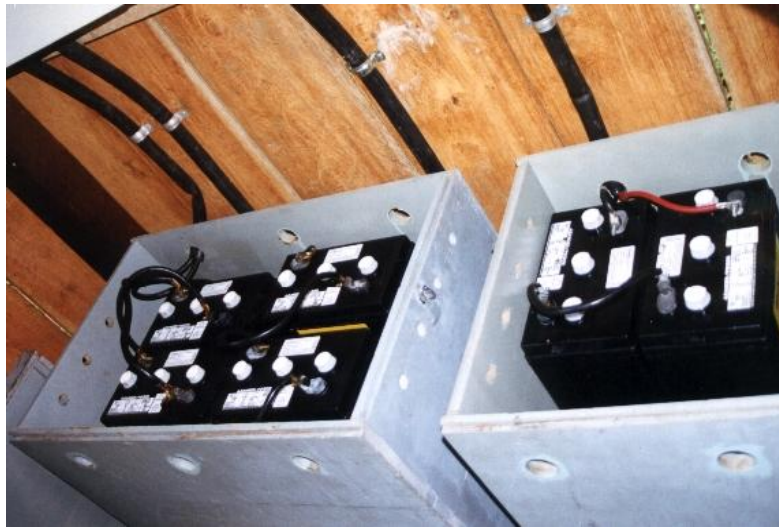
Figura 7.19 – Vista de baterias no interior de uma caixa especialmente construída para seu acondicionamento (Foto cedida pelo LSF-IEE/USP).
