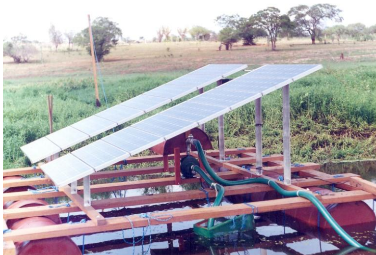
Figura 7.16 – Geradores fotovoltaicos instalados sobre uma plataforma flutuante (Foto cedida pelo Cepel).
