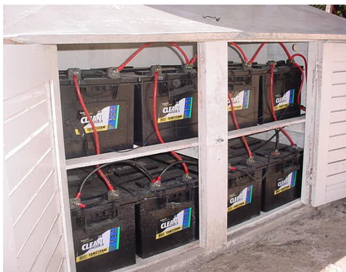
Figura A3.6 – Baterias do sistema fotovoltaico de Bom Futuro. Fonte: GEDAE.
