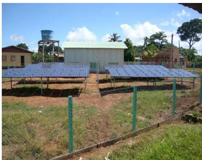
Figura A3.8 – Geradores fotovoltaicos da comunidade de Sobrado. Fonte: (ELETROBRAS, 2011).
