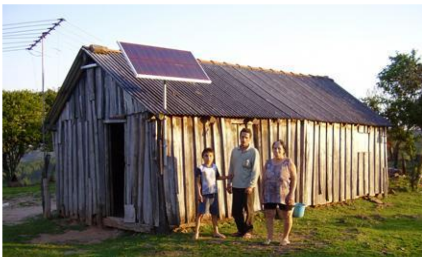
Figura 7.11 – Sistema fotovoltaico residencial instalado em localidade isolada do Rio Grande do Sul. Fonte: (IDEAAS, 2012).
