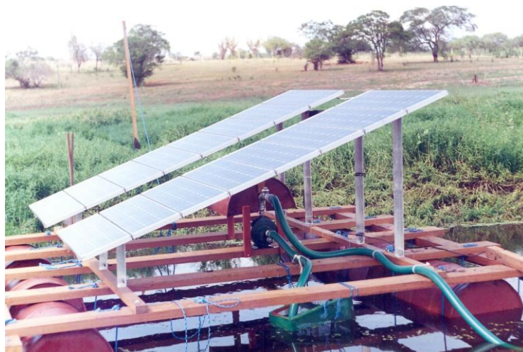
Figura A3.1 – Sistema fotovoltaico de bombeamento do Açude do Rio de Peixe (Foto cedida pelo Cepel).
