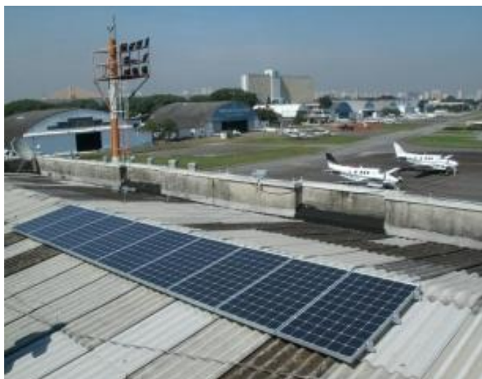
Figura A3.15 – Gerador fotovoltaico instalado na cobertura do prédio administrativo do aeroporto Campo de Marte. Fonte: (JORNAL DA ENERGIA, 2013).
