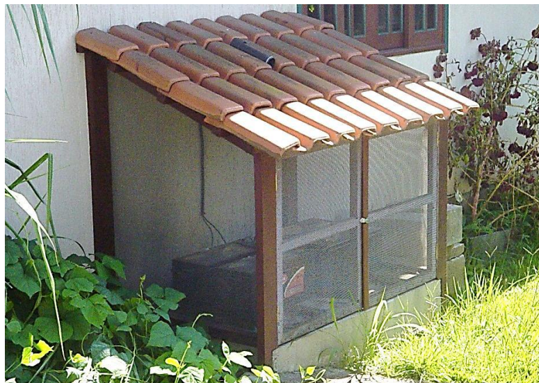
Figura 7.20 – Abrigo de baterias bem ventilado e instalado na lateral de uma escola (Foto cedida pelo LSF-IEE/USP).
