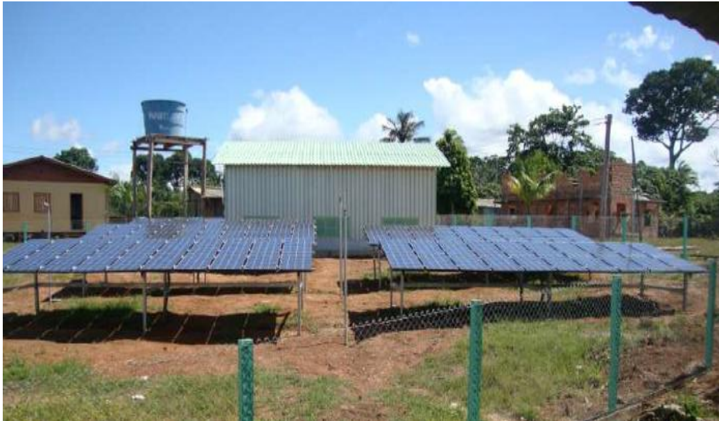
Figura 5.10 – Sistema MIGDI fotovoltaico da comunidade de Sobrado no Amazonas. Fonte: (Eletrobras. Apresentação na 1º INOVA FV, 2011).
