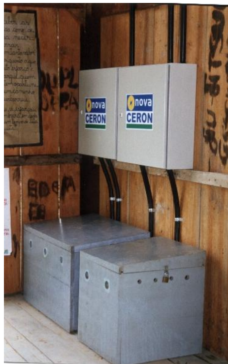
Figura 7.18 – Detalhe de compartimento para baterias com orifícios na parte superior para ventilação (Foto cedida pelo LSF-IEE/USP).
