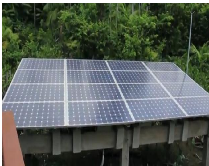
Figura A3.9 – Vista de um dos geradores fotovoltaicos instalados nas ilhas de Araras. Fonte: (PAC 2, 2013).
