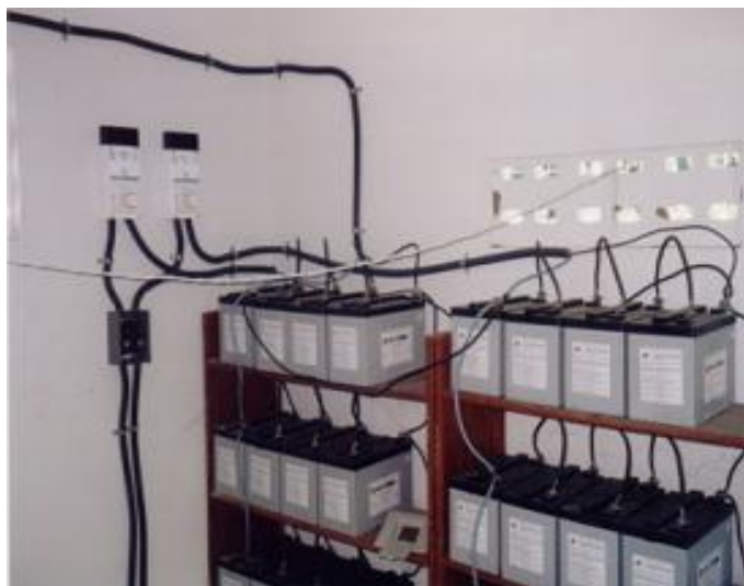
Figura A3.4 – Controladores de carga e banco de baterias de Itacoã. Fonte: GEDAE.
