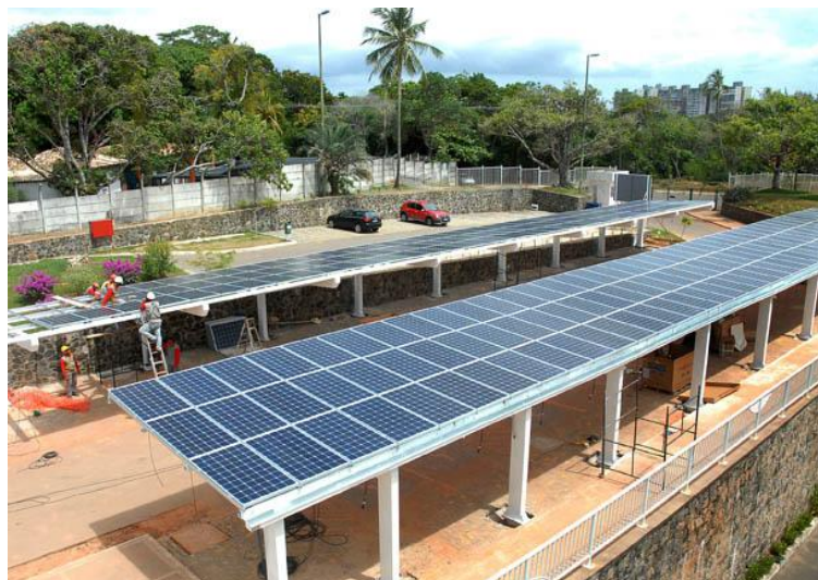
Figura A3.16 – Sistema fotovoltaico instalado na cobertura do estacionamento em Pituaçu. Fonte: (AMERICA DO SOL, 2012).
