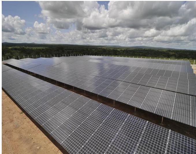
Figura A3.14 – Vista dos geradores fotovoltaicos da Usina Solar de Tauá. Fonte: (VIDRADO.COM, 2013).
