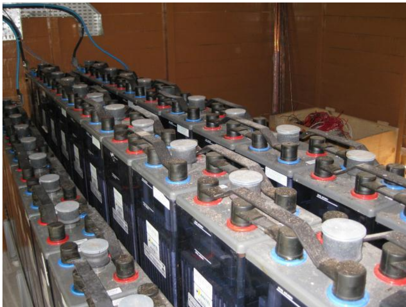
Figura 7.23 – Banco de baterias em MIGDI da Celpa, na Ilha de Araras (Marajó-PA) (Foto cedida pela CELPA).
