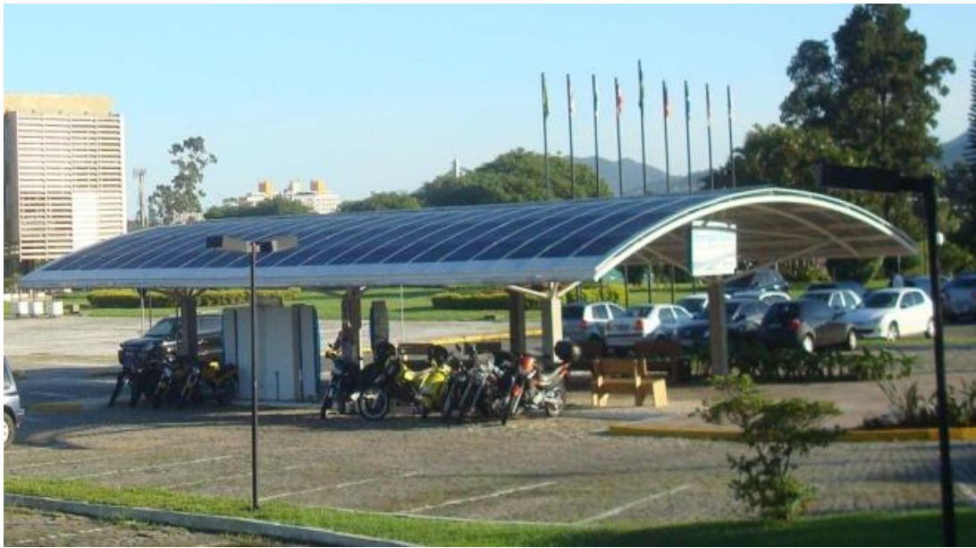
Figura 6.14 - Planta Piloto do Megawatt Solar - Eletrosul - Florianópolis - 11,97 kWp - em operação desde Fev/2009.
