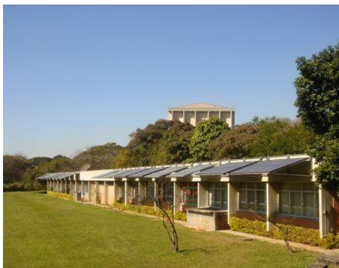
Figura A3.13 - Sistema fotovoltaico de 12 kW instalado na fachada do prédio da administração do IEE. Fonte: LSF.
