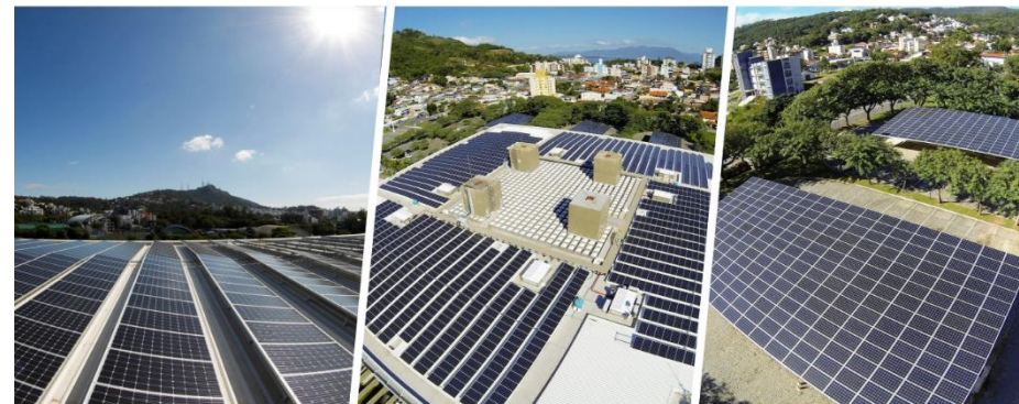
Usina Megawatt Solar, Florianópolis. Sede Administrativa Eletrosul
