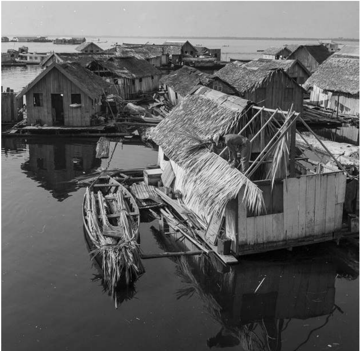
Imagem 66: Flutuantes com telhado de palha em construção. Sem título dado pelo autor. (Fonte: Acervo fotográfico do IMS / Foto: Marcel Gautherot, entre 1955 e 1966)
