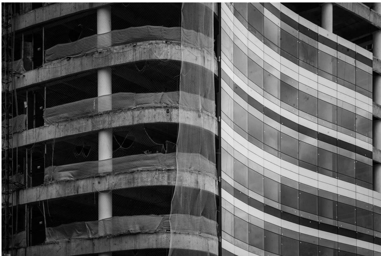
Obra na avenida Rebouças, na zona oeste de São Paulo - Zanone Fraissat/Folhapress
