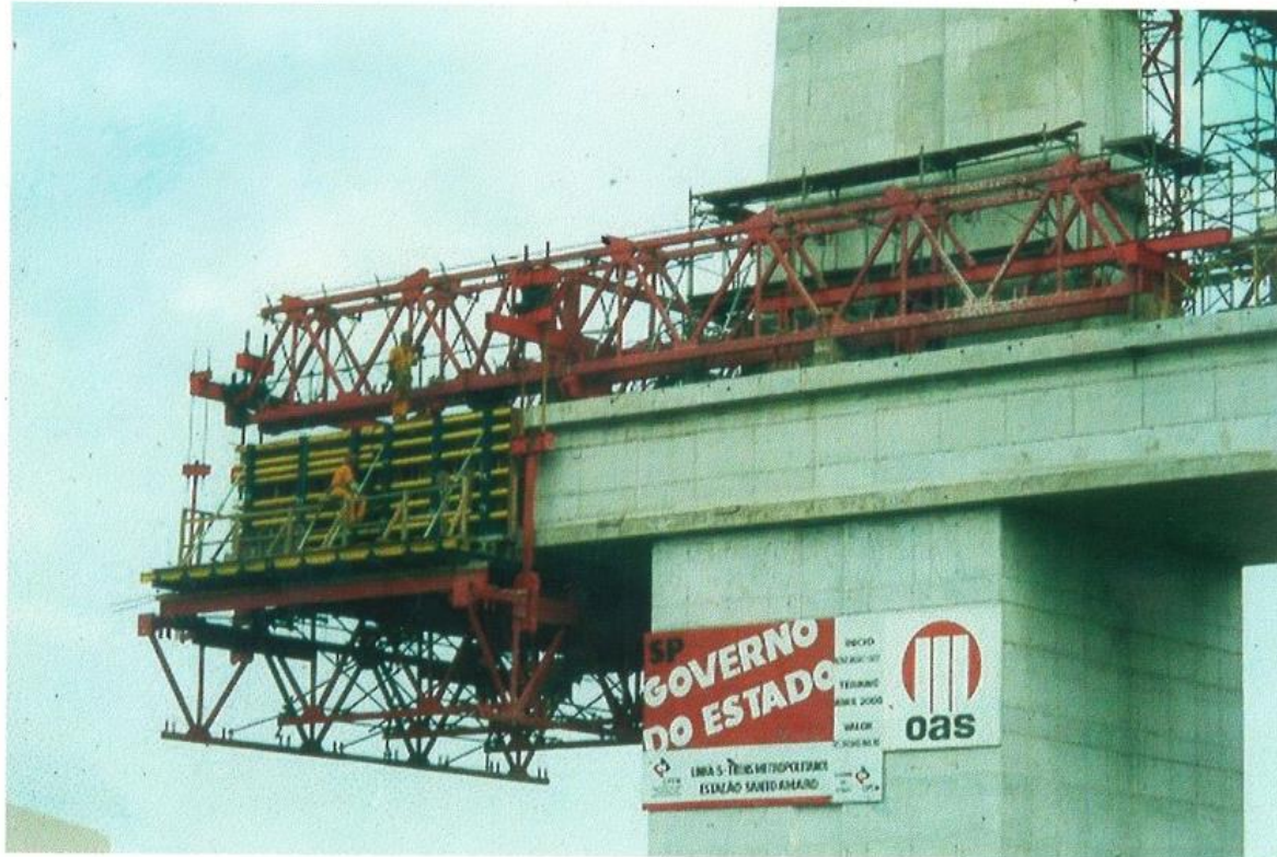
Treliça de escoramento dos segmentos do tabuleiro da ponte (fotografia de Anderson Glauco Benite)
