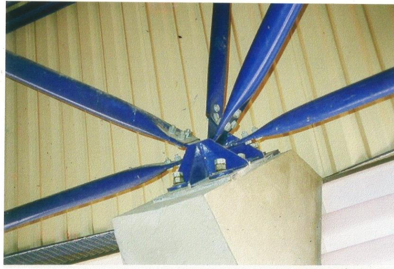
Detalhe de um dos apoios da cobertura (fotografia de Nayra Tais Savordelli)
