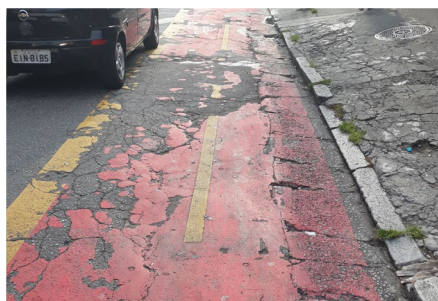
A) Trincas transversais
