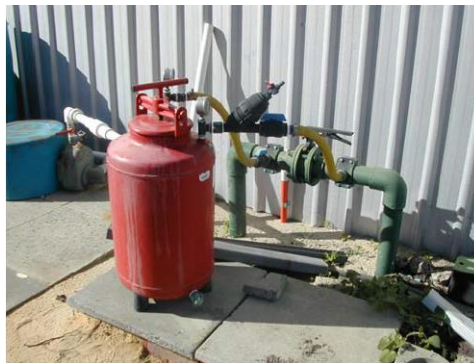
Figura 6. Tanque de injeção de fertilizantes.
