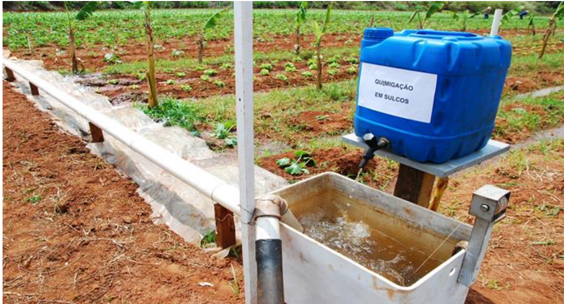
Figura 8. Equipamento para quimigação de baixo custo em sulcos.
