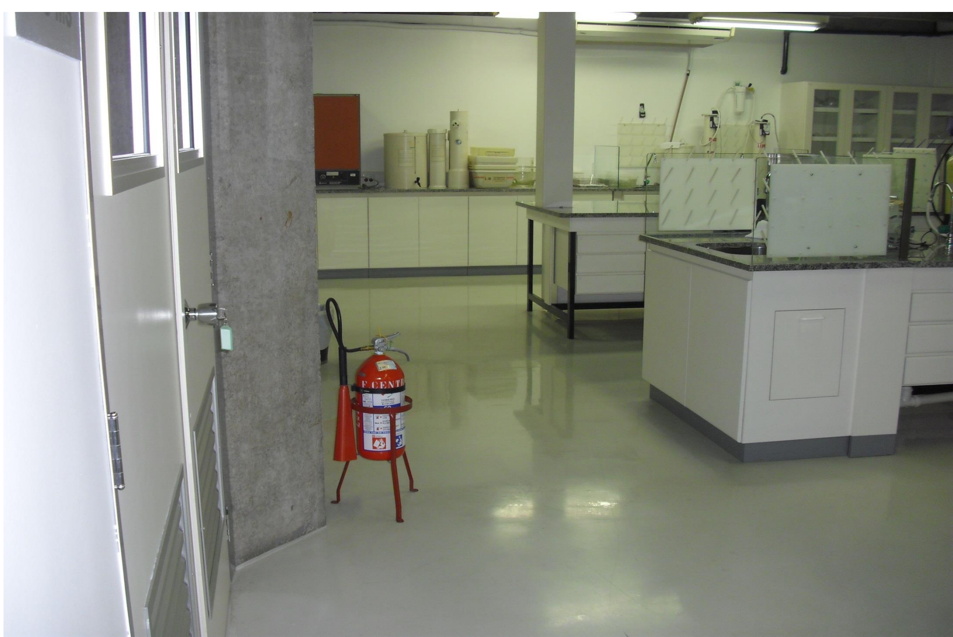
Extintor de Incêndio em Laboratório
