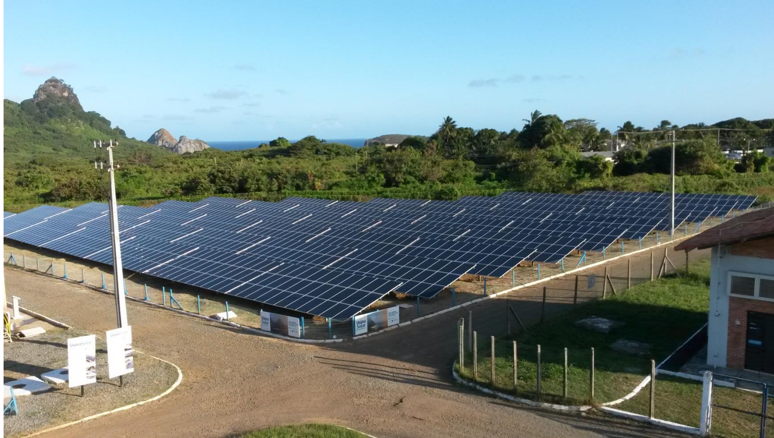
Usina FV Fernando de Noronha I, 400 kWp (CELPE)
