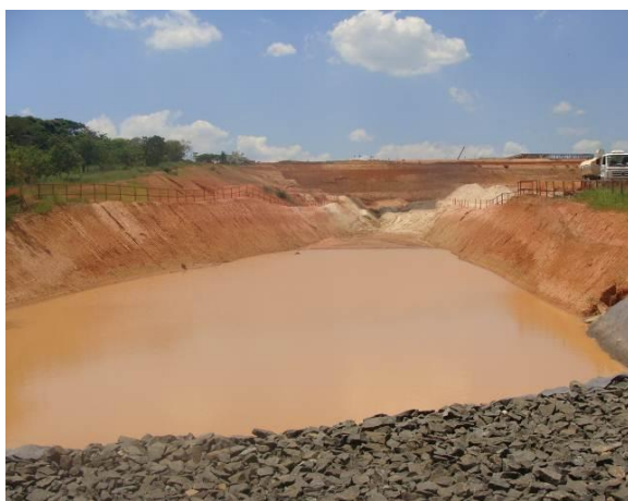
Figura 15 - Bacia de contenção de sedimentos em obras aeroportuárias
