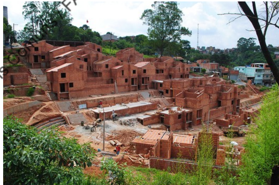
Imagem: 2015, Comunidade Helder Camara, habitação social co-projetada pela USINA CTAH (© USINA CTAH, 2015 )
