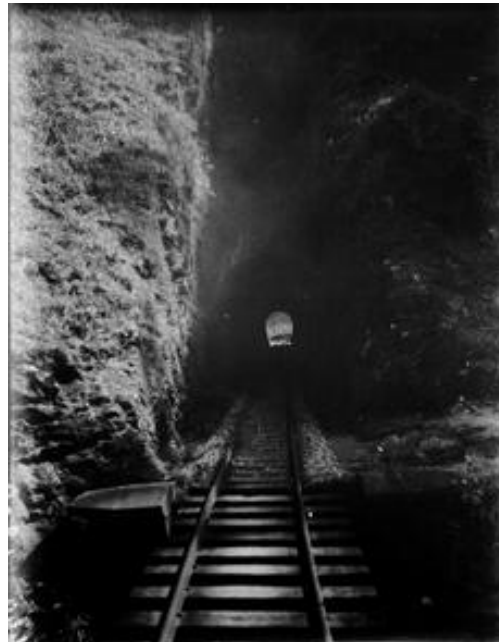
Fig. 52. Túnel na linha Ouro Preto. Negativo em vidro. Gelatina/prata, 10 x 8,5 cm. Legenda original.
