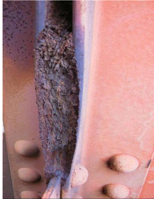
Fresta formada entre duas paredes metálicas em contato
