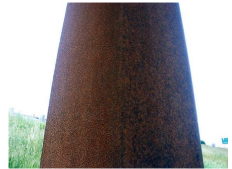
Corrosão atmosférica de aço patinável
