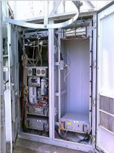
Estação Rádio Base
