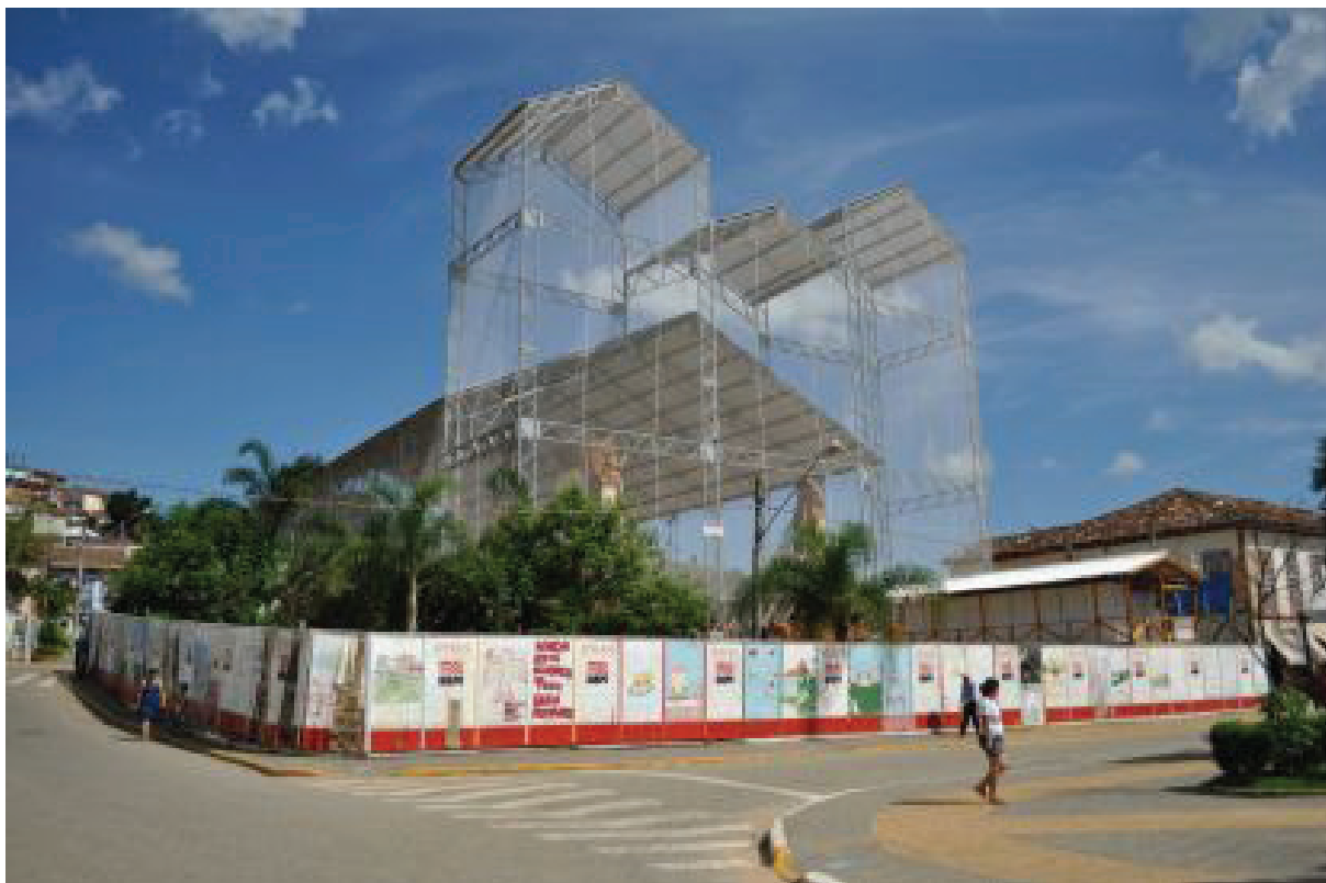
Figura 40: Cobertura metálica marcando a volumetria da Igreja Matriz, São Luiz do Paraitinga. Fonte: Acervo da pesquisa, 2012.
