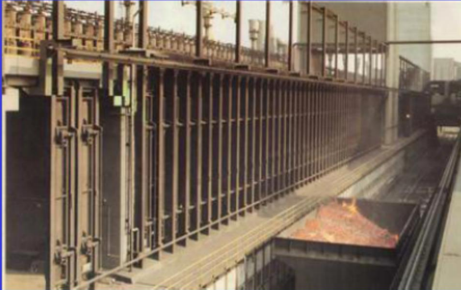
Típica Bateria de coqueificação
