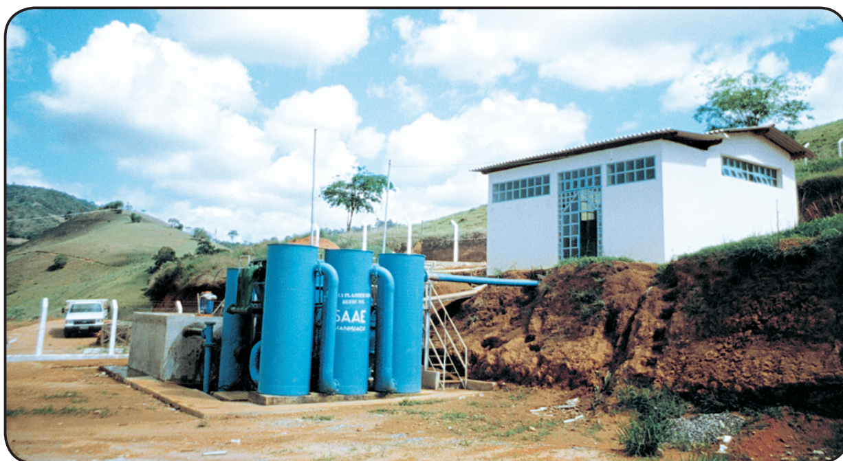
Foto 4 – ETA compacta com casa de química
