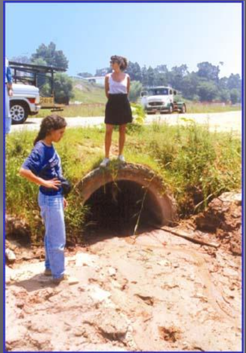
sistema superficial de drenagem construída assoreado – capacidade de vazão reduzida à metade
