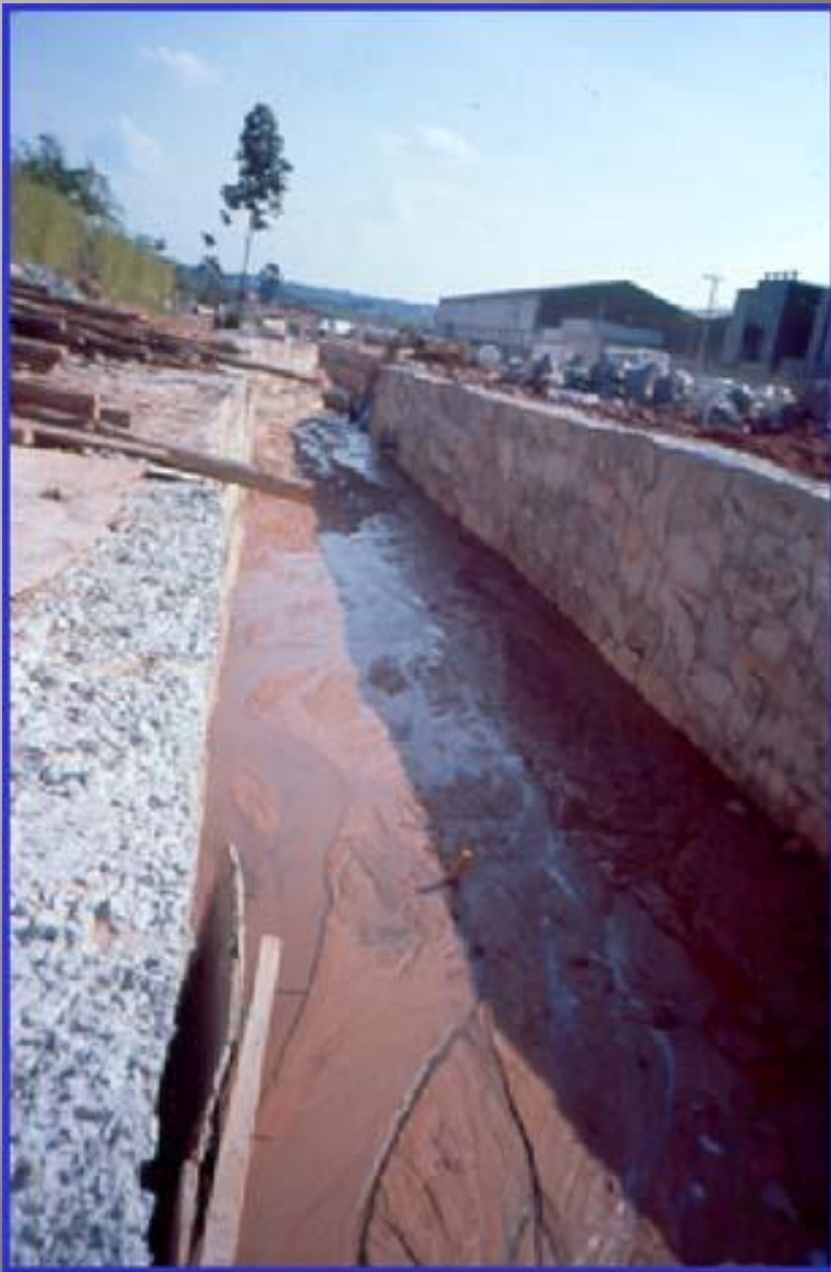
Sistema superficial de drenagem de águas pluviais assoreado
