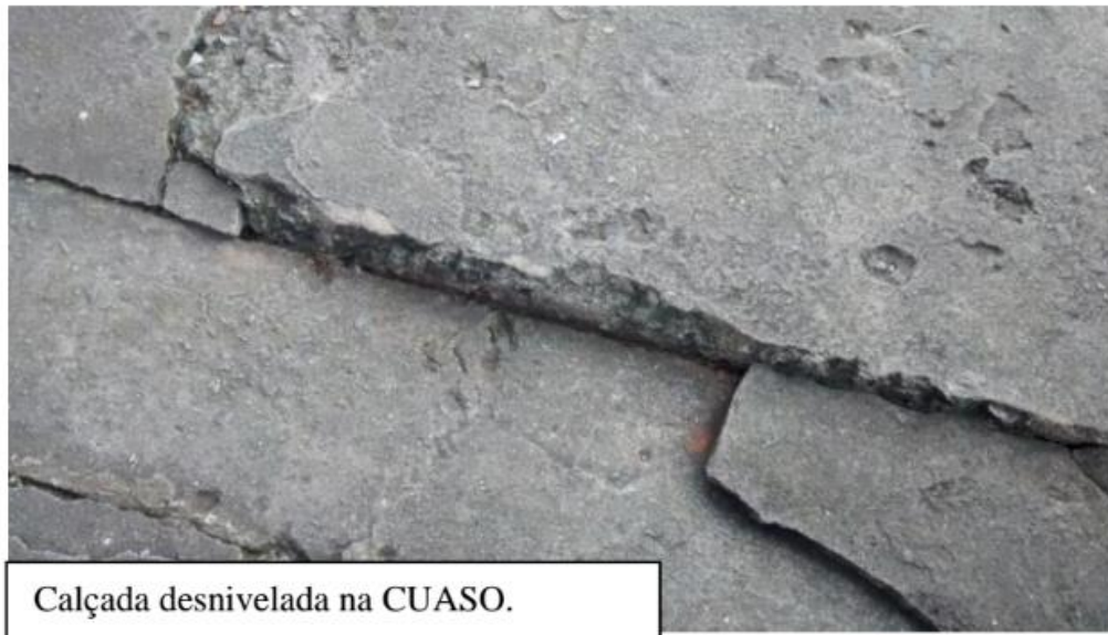
Figura 2.1-2 - Calçada desnivelada na CUASO.
