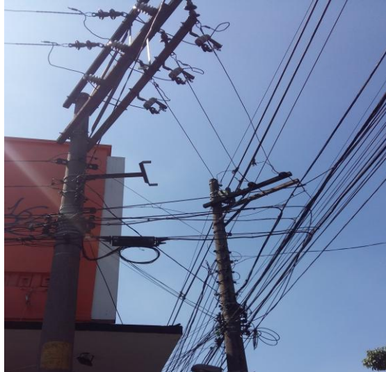
Cabos aéreos (rua Camargo)
