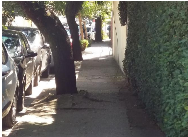
Calçada fraturada pelas raízes de uma árvore com passo estreito ao lado
