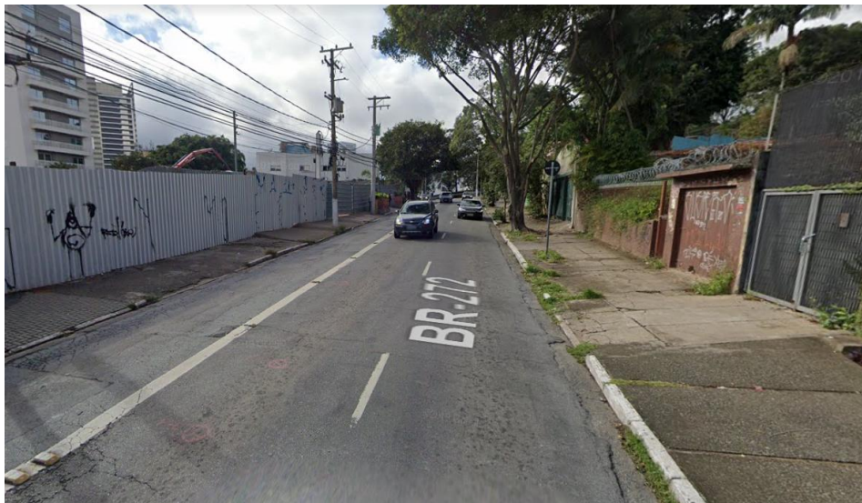
rua MMDC - calçada em más condições
