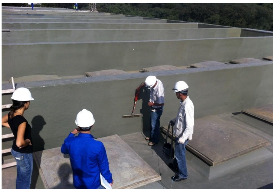
Figura 13: Teste de detecção de falha na membrana de poliureia utilizando o equipamento Holiday Detector . Foto: Rodrigo Vergili, 2016.
