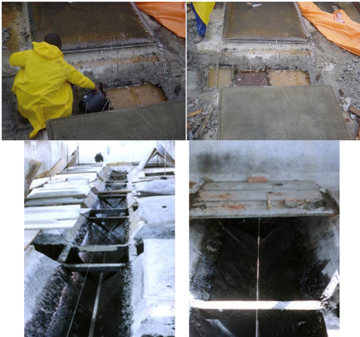
Figura 8: Acima, as imagens ilustram o acúmulo de água nos caixões perdidos devido às falhas no sistema de impermeabilização (Fonte: HELENE, PEREIRA, BARBOSA, 2006). Abaixo, o posicionamento de componentes pré-moldados de argamassa armada que serviram de assoalho da fôrma para a nova concretagem da laje (ISOTERMA CONSTRUÇÕES TÉCNICAS LTDA, 2002).
