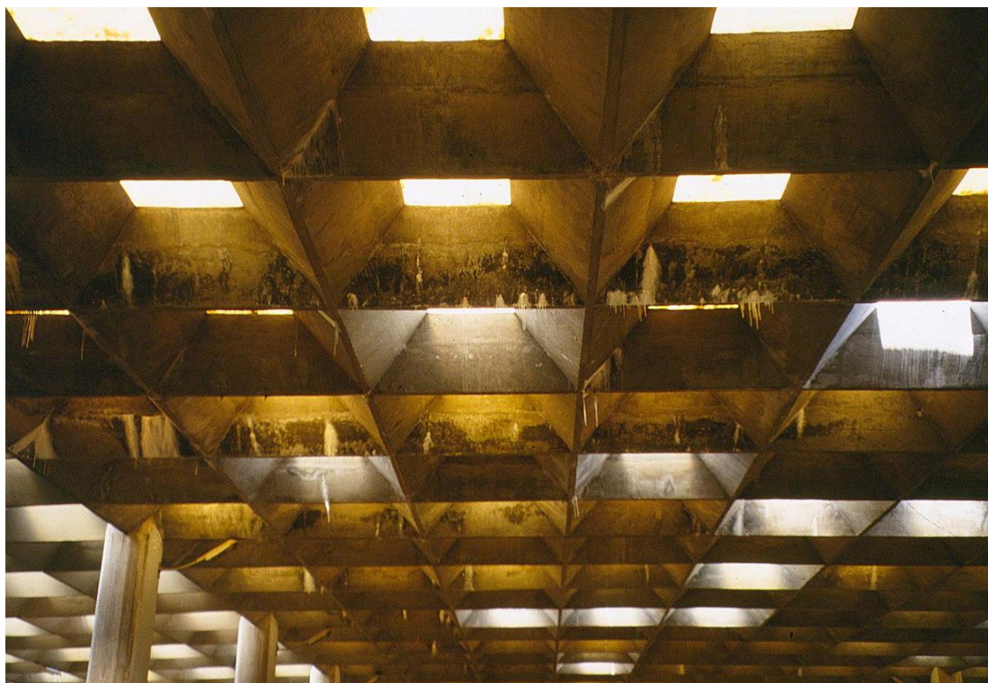
Figura 7: Estalactites nas vigas da cobertura. Foto: Maria Lucia Bressan Pinheiro, 2003.
