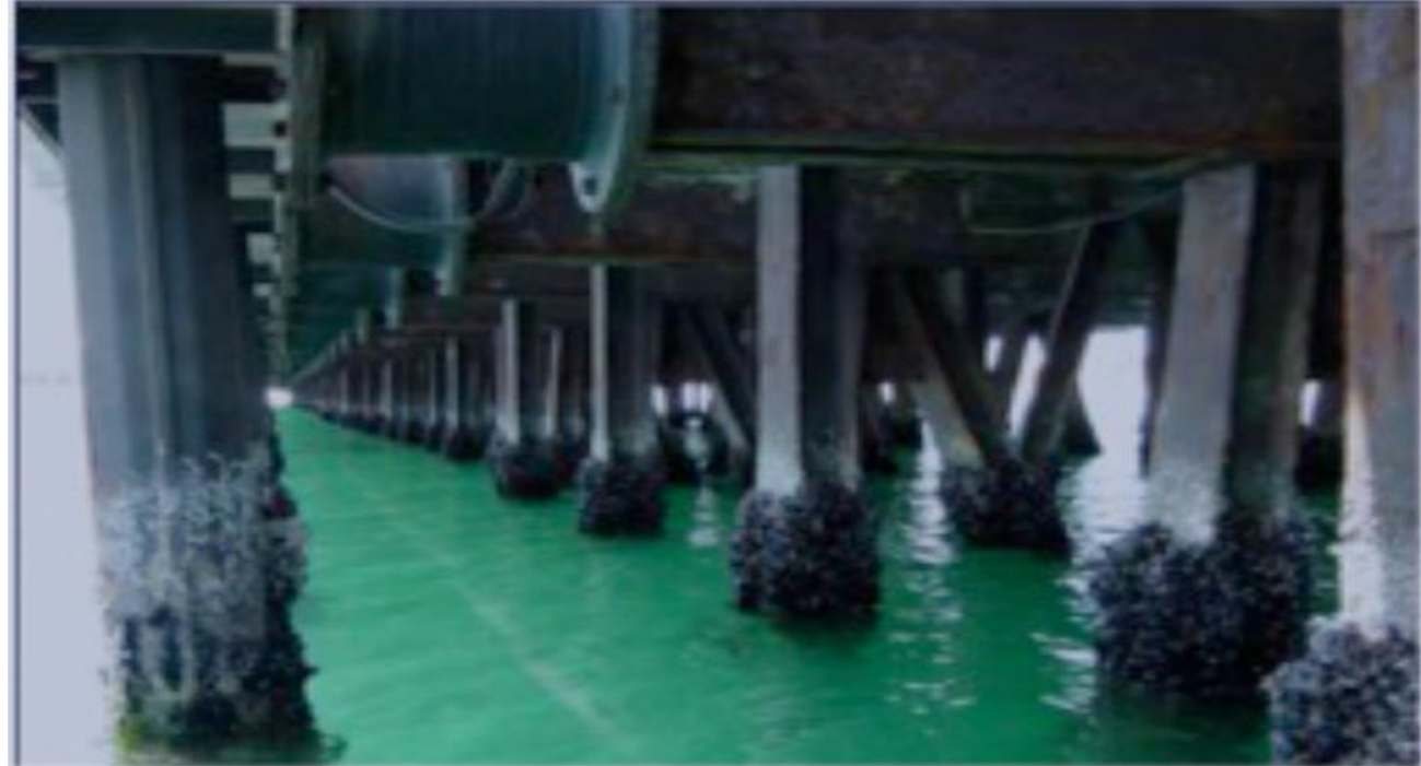
Corrosão microbiológica em zona de maré
