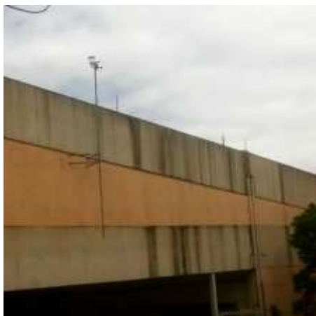
Figura 11. Instalação da Estação Meteorológica no prédio dos laboratórios do IFMG Campus Congonhas.
