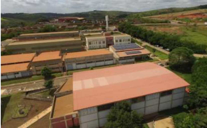
Figura 4. Instalação da usina de energia fotovoltaica no telhado do prédio dos laboratórios do IFMG Campus Congonhas.
