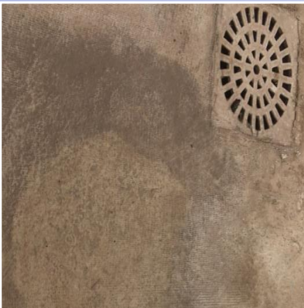
Acúmulo de água
