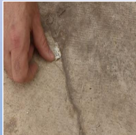
Falha com estruturante
