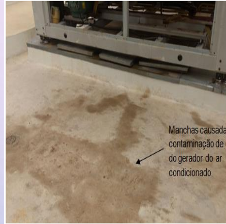
Manchas- reação química
