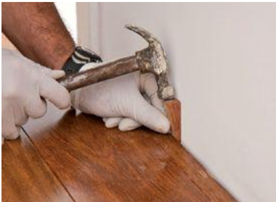
Colocação das cunhas para empurrar e encaixar as peças e dar espaço para movimentação da madeira
