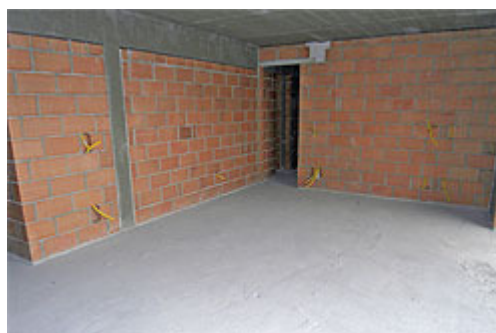
Foto 2 - As lajes dos diversos ambientes devem estar secas e limpas, livres de resíduos de argamassa ou outros materiais aderidos à base que possam comprometer o seu correto nivelamento ou mesmo que possam perfurar a manta acústica
