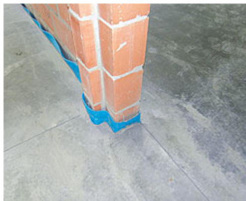
Foto 11 - Juntas de movimentação na região dos batentes
