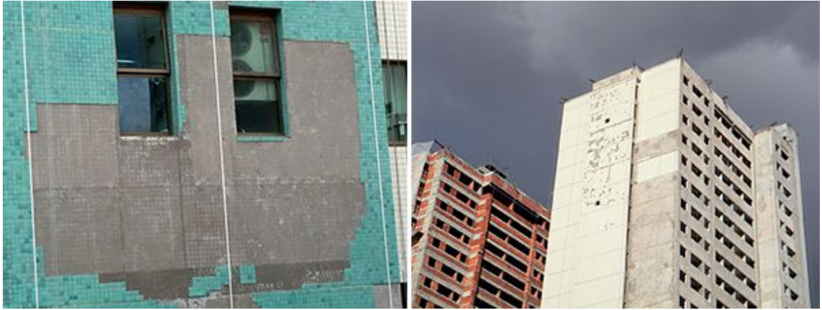
Fora dos grandes centros urbanos, ainda não se disseminou por completo o hábito de se realizar projetos de fachada, o que pode dar origem a manifestações patológicas no revestimento
