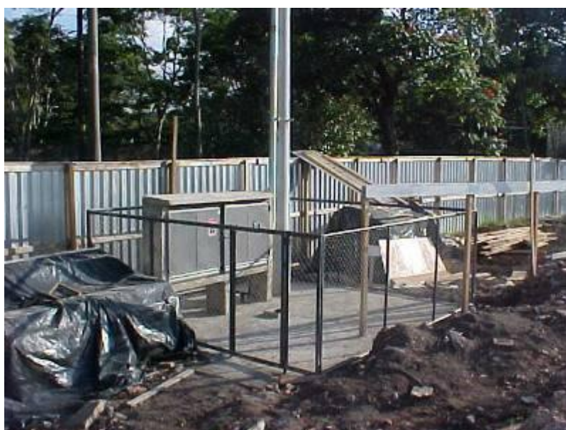
Figura 2.2 Quadro de entrada de energia adequado
