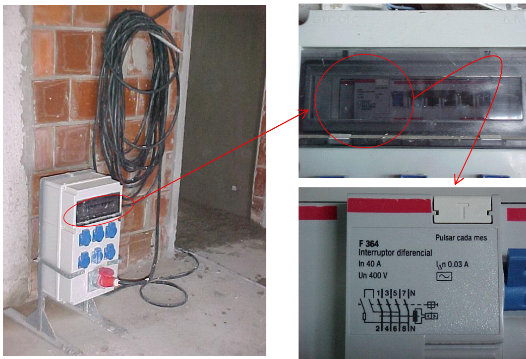
Figura 2.4 - Quadros de energia adequados à utilização em canteiros de obras, inclusive com dispositivo de segurança "IDR", prevenindo a fuga de corrente (Fonte: Barkokébas Junior, Béda, 2005).
