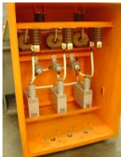
Figura 8.31. - Caixa de ligação principal com para-raios, capacitor e TC.
