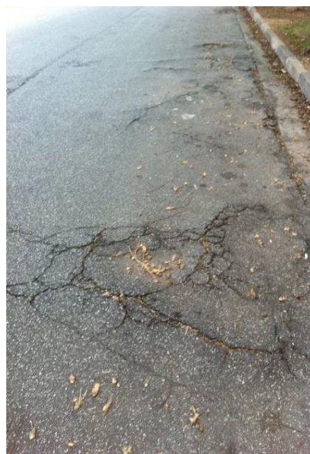
Figura 7-5 - Foto da má condição do pavimento nas vias da CUASO
