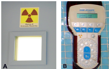
Figura 3. Exemplo de aviso de restrição de entrada de pessoas, visor de vidro na porta (A) e acionador de disparo (B) no lado externo da sala de exame radiográfico.
