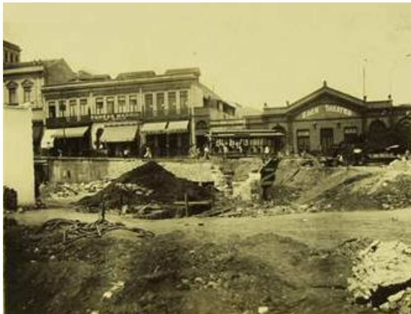
Imagem 94: Vista da Ladeira São João durante as obras de alargamento desta via em 1910. Fonte: BMA, álbum Washington Luiz, vol.1, 1862-1900-16.
