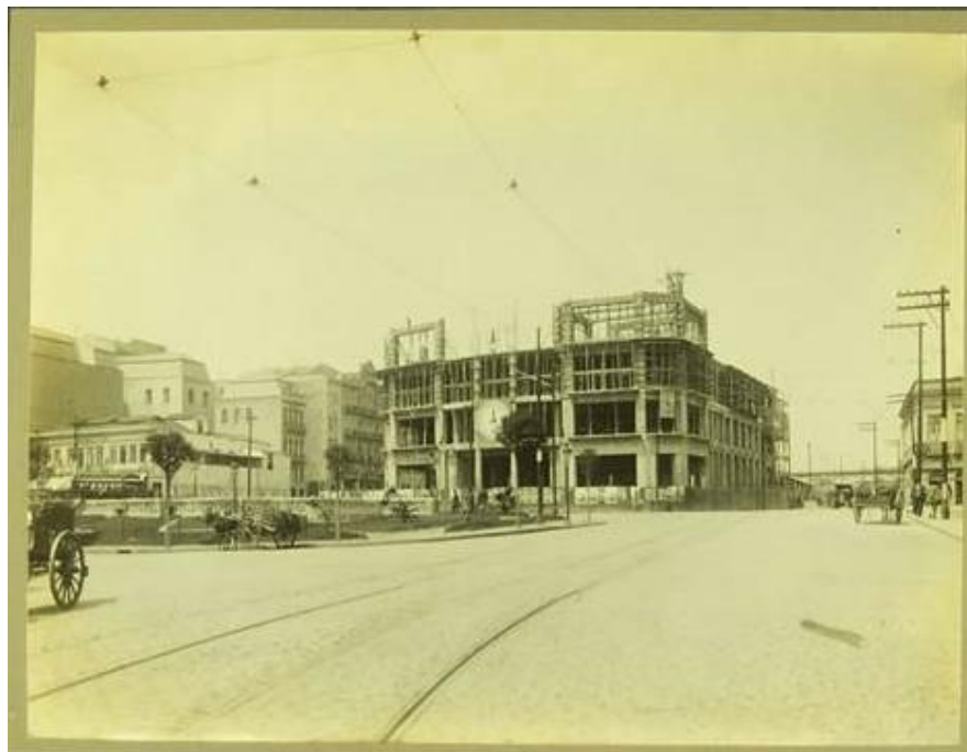
Imagem 235: Em construção o prédio do Casino Antarctica, 1916. Fonte: BMA, álbum Washington Luiz, vol.2, 1862-1900-16.
