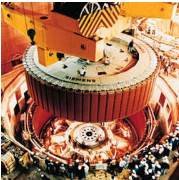
Rotor e estator de unidade geradora de Itaipu
