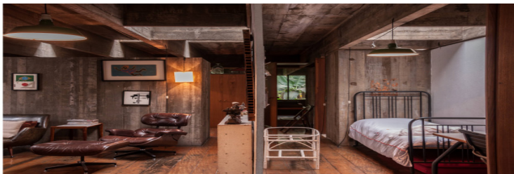
Figura 10: Legenda: Vista da sala de estar e dos quartos, nas quais se pode observar a distância entre as vedações e a laje. Fonte: Foto de Lauro Rocha.
