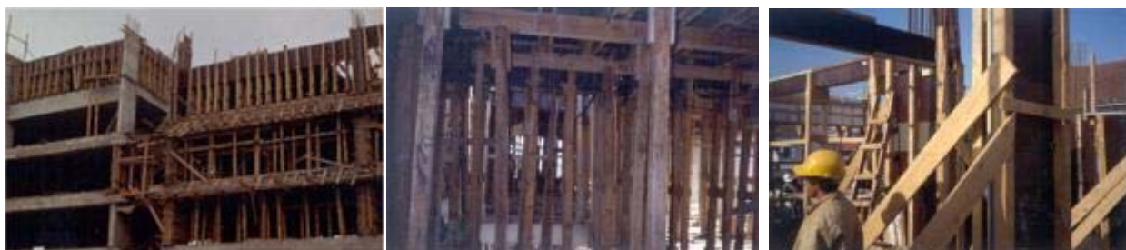
Figura 6 – Sistemas de fôrmas comumente utilizados em processos tradicionais de produção de ERCA (fonte: arquivo Mercia Bottura de Barros)
