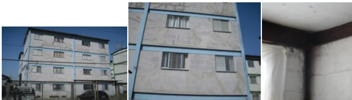
Figura 18 - Fissuras generalizadas na vedação e infiltração no encontro alvenaria estrutura (Fonte: Fotos cedidas por Eng. Fernanda Belizario Silva, junho/2009).
