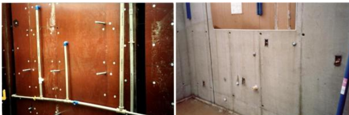
Figura 14 – Sistema de paredes maciças com embutimento de sistemas hidráulicos, sem a possibilidade de manutenção futura (fonte: arquivo Mercia Bottura de Barros).
