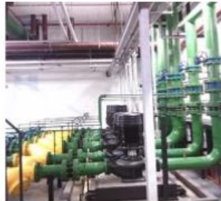
Bombas de Água Gelada e Condensação
